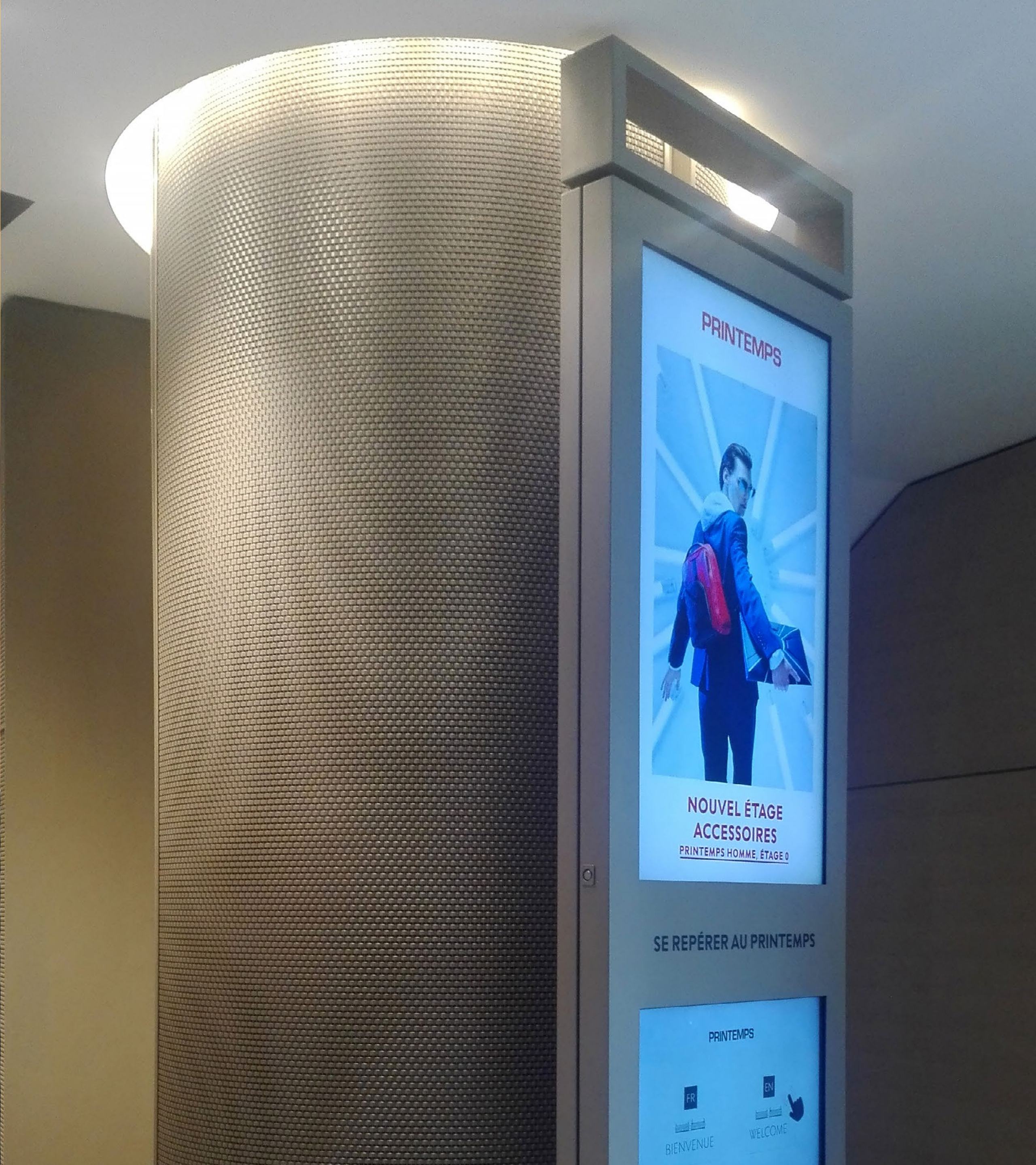
La Monnaie du Trésor - Pologne Goettsch Partners / Epstein Agence à Varsovie Grille de ventilation
